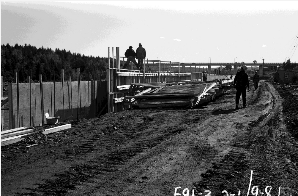
Construction d'un mur de soutènement, Alma, 1964. Source : Société d'histoire du Lac-Saint-Jean, fonds Krieger, (F91).
